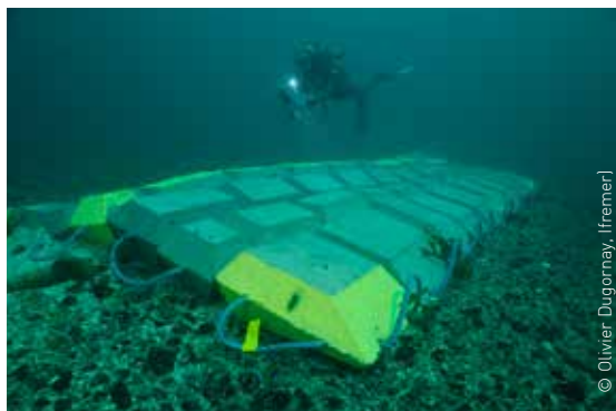
Fig. 25 : Vue d'ensemble d'un des sites de suivi où sont visibles le câble protégé par une coque en fonte et un matelas de béton stabilisateur.
