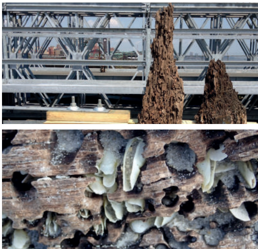
Fig 11. Piles en bois endommagées par des organismes perceurs (haut) tels que le Taret ( Toredo sp.) (bas).
